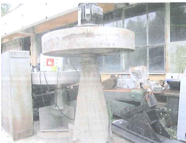
Fot. 1. Widok aeratora powierzchniowego pływającego typu Agua Turbo o mocy 11 kW, własności ZGKiM w Stąporkowie.
